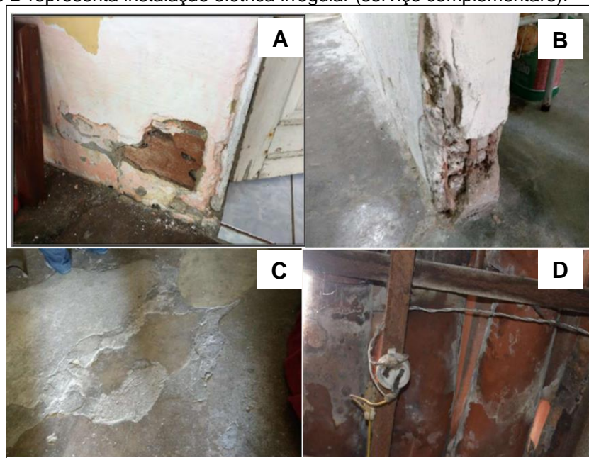
Figura 4: Fotos do estado patológico de alvenaria e instalação elétrica de residências do Conjunto Habitacional de Maranguape II. As figuras A e B representam queda de reboco e alvenaria, respectivamente (superestruturas); C representa infiltrações ascendentes no piso (infraestruturas) e D representa instalação elétrica irregular (serviço complementare).
